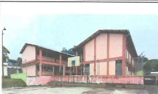
Foto 2: La pintura del muro perimetral se encuentra deteriorada, parte exterior.
