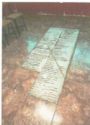
Foto 5: El azulejo del aula está dañado.
