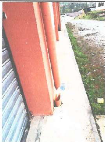
Foto1: El tubo está dañado.
