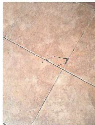
Foto 6: El azulejo del corredor está dañado.
