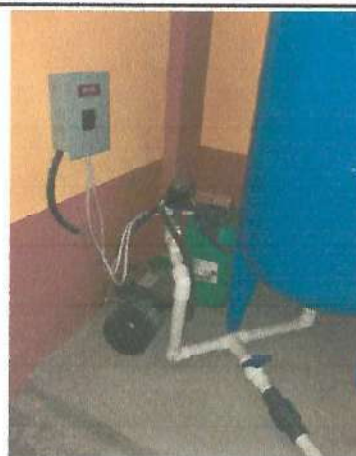
Foto 10: El motor de arranque de Cisterna está dañado.
