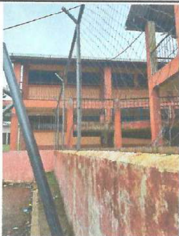
Foto 9: El alambre de puas del muro perimetral está dañado.
